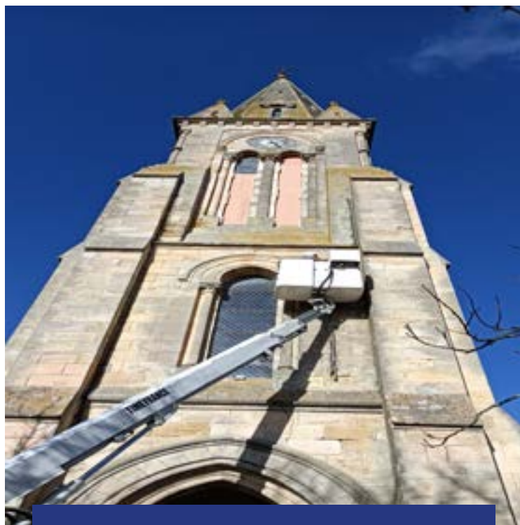
Sécurisation des vitraux suite à la tempête.
